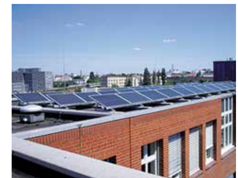
Abbildung 12 Aufgeständerte Photovoltaikanlage der Moses-Mendelssohn-Oberschule Berlin
