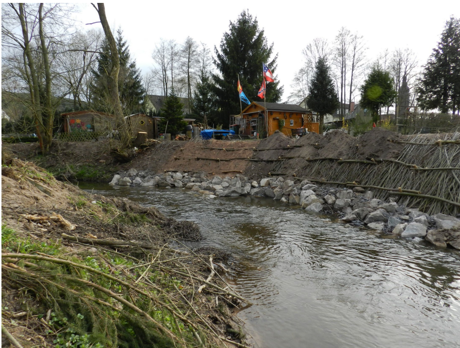
Abbildung 18: Weidenspreitlage mit Böschungfußsicherung in der Ortslage Laasdorf kurz vor der Fertigstellung am 20. April 2013. (Quelle: M. Dittrich 2013)
