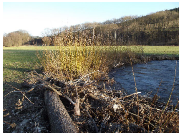
Foto 22: Eingewachsene Spreitlagen bieten einen sehr guten Böschungsschutz. Schadensanfällig sind jedoch die Übergangsbereiche zu ungesicherten Abschnitten oder anderen Bauweisen. Hier ist besonders auf eine korrekte Bauausführung zu achten. (Foto: A. Stowasser)
