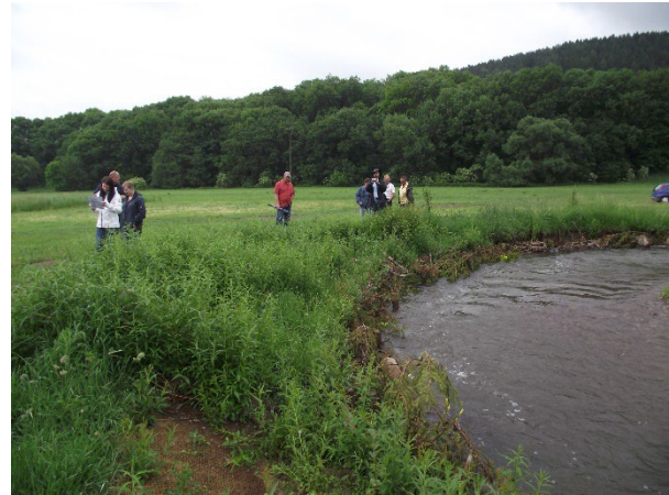
Foto 20: Die Spreitlage bietet bereits wenige Wochen nach Fertigstellung einen flächigen Böschungsschutz. (Foto: A. Stowasser)
