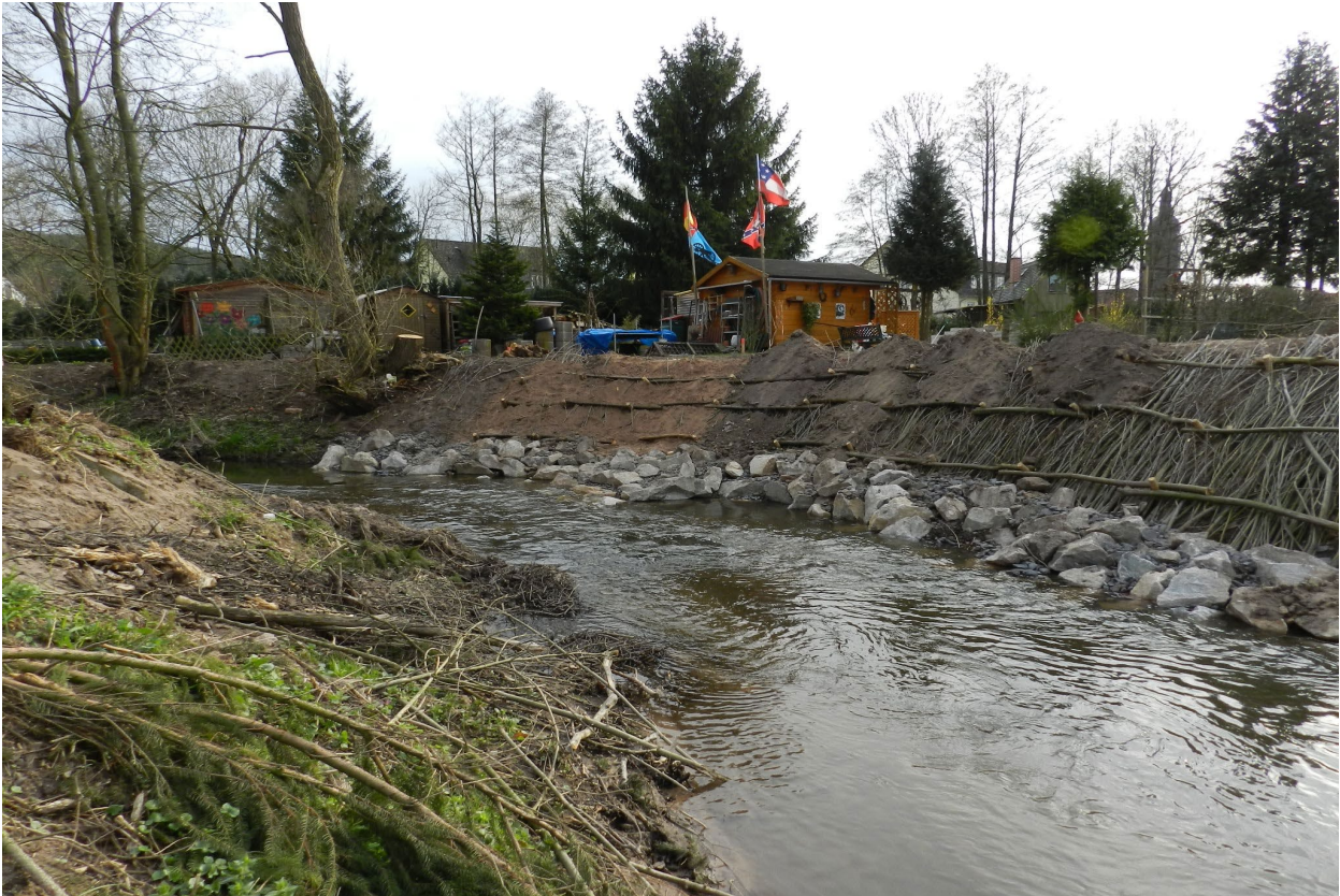
Abbildung 6: Weidenspreitlage mit Böschungsfußsicherung in der Ortslage Laasdorf kurz vor der Fertigstellung am 20. April 2013. (Quelle: M. Dittrich 2013)
