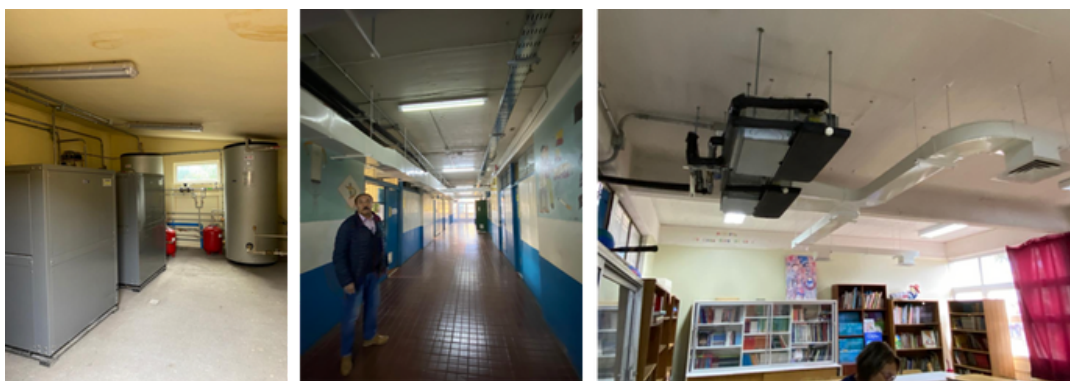
Figura 6. Fotografías de instalaciones geotérmicas en Escuela Luis Cruz Martínez, Curacautín, Chile
